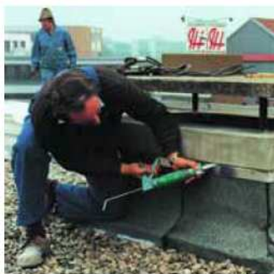
Эластичная герметизация соединительных швов вытяжной трубы между бетоном и фартуком из нержавеющей стали.
