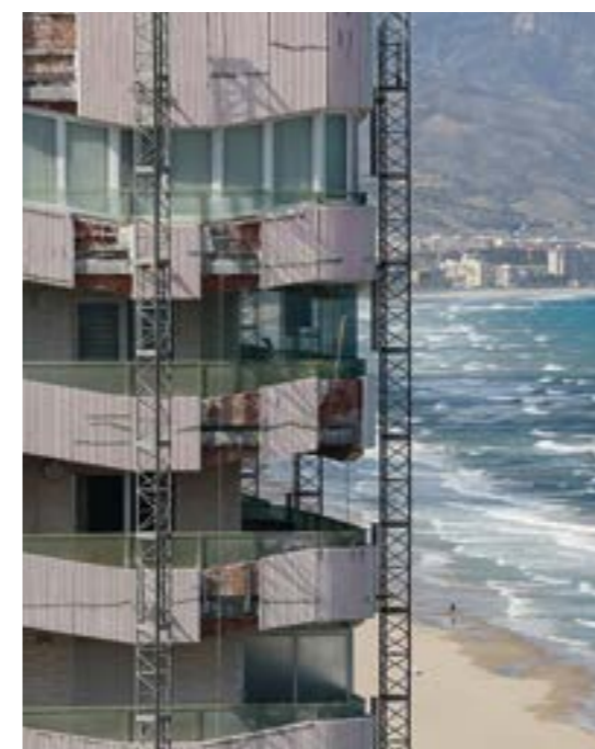
Правило 1: Защита от проникновения хлоридов Торрес Бланкас, Аликанте, Испания; Защита с помощью ингибитора коррозии MasterProtect 8000 CI
