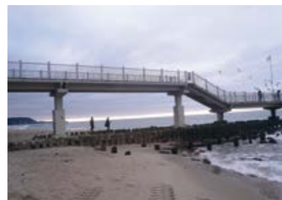
2003 год, Светлогорск. Капитальный ремонт променада «Капитанский мостик». Гидроизоляция и защита пролетных сооружений и опор MasterSeal 588. На фото мониторинг объекта в 2013 году.
