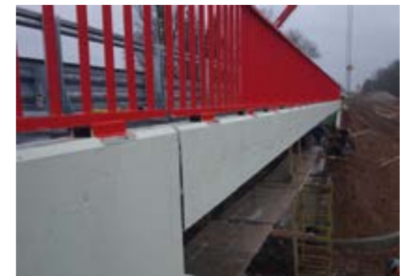
2013 г. Мост через реку Зарезница на км 301+469 автомобильной дороги М-20 Санкт-Петербург–Псков–Пустошка–Невель до границы с Республикой Беларусь, Псковская область. Защитное покрытие MasterProtect 330 EI
